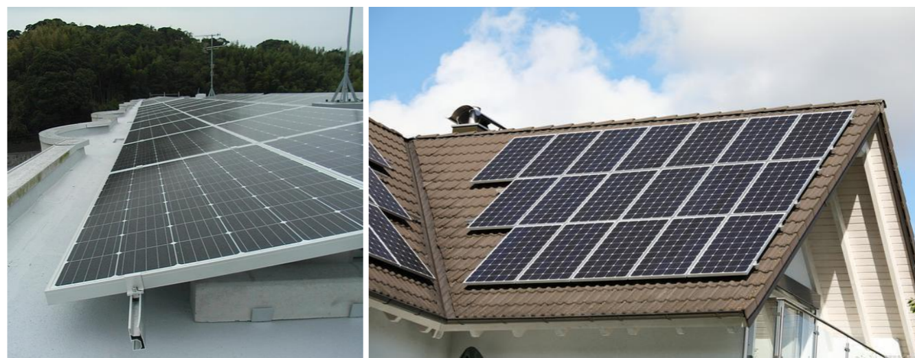
平屋面光伏板
